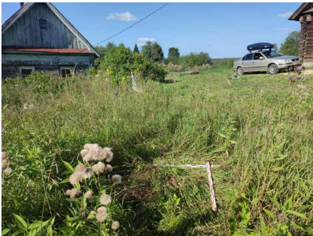
Рис.29. «Строительство распределительного газопровода в д. Угор Верхошижемского района Кировской области» в Верхошижемском районе Кировской области. Шурф 2. Закладка. Вид с Ю.
