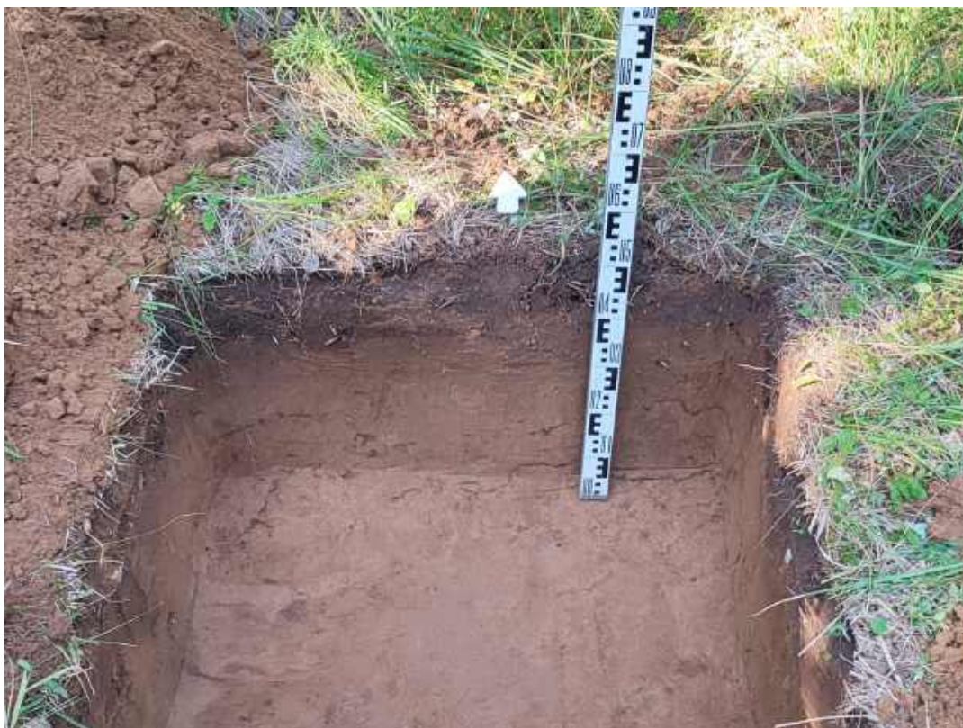
Рис.26. «Строительство распределительного газопровода в д. Угор Верхошижемского района Кировской области» в Верхошижемском районе Кировской области. Шурф 1. Северный борт. Вид с Ю.
