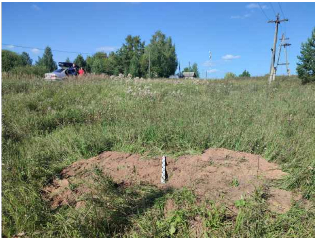
Рис.63. «Строительство распределительного газопровода в д. Угор Верхошижемского района Кировской области» в Верхошижемском районе Кировской области. Шурф 8. Рекультивация. Вид с Ю.
