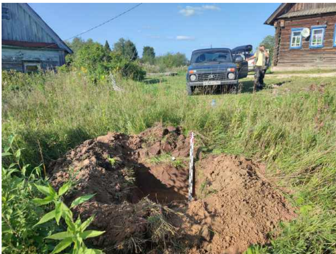
Рис.30. «Строительство распределительного газопровода в д. Угор Верхошижемского района Кировской области» в Верхошижемском районе Кировской области. Шурф 2. Антураж. Вид с Ю.
