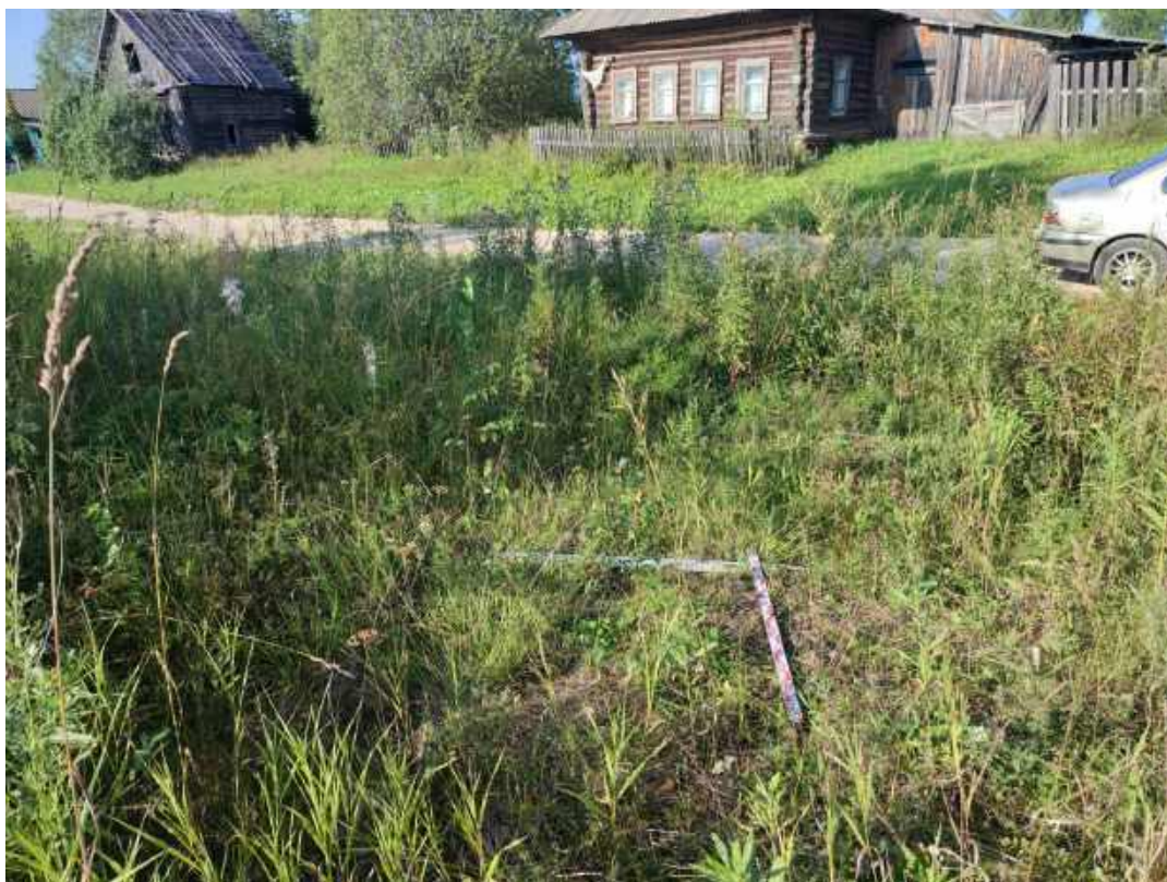
Рис.39. «Строительство распределительного газопровода в д. Угор Верхошижемского района Кировской области» в Верхошижемском районе Кировской области. Шурф 4. Закладка. Вид с Ю.
