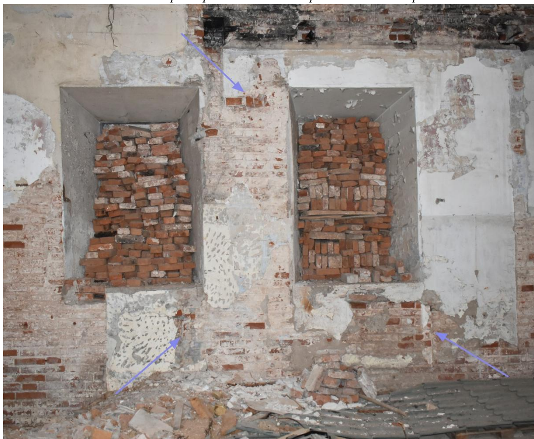
Ил.14. Помещение четверика, внутренняя поверхность наружной северной стены Зафиксированы следы заложенного дверного проема. Наличие стыков без перевязки с незначительным смещением рядов кирпичной кладки. Следы перемычки.
