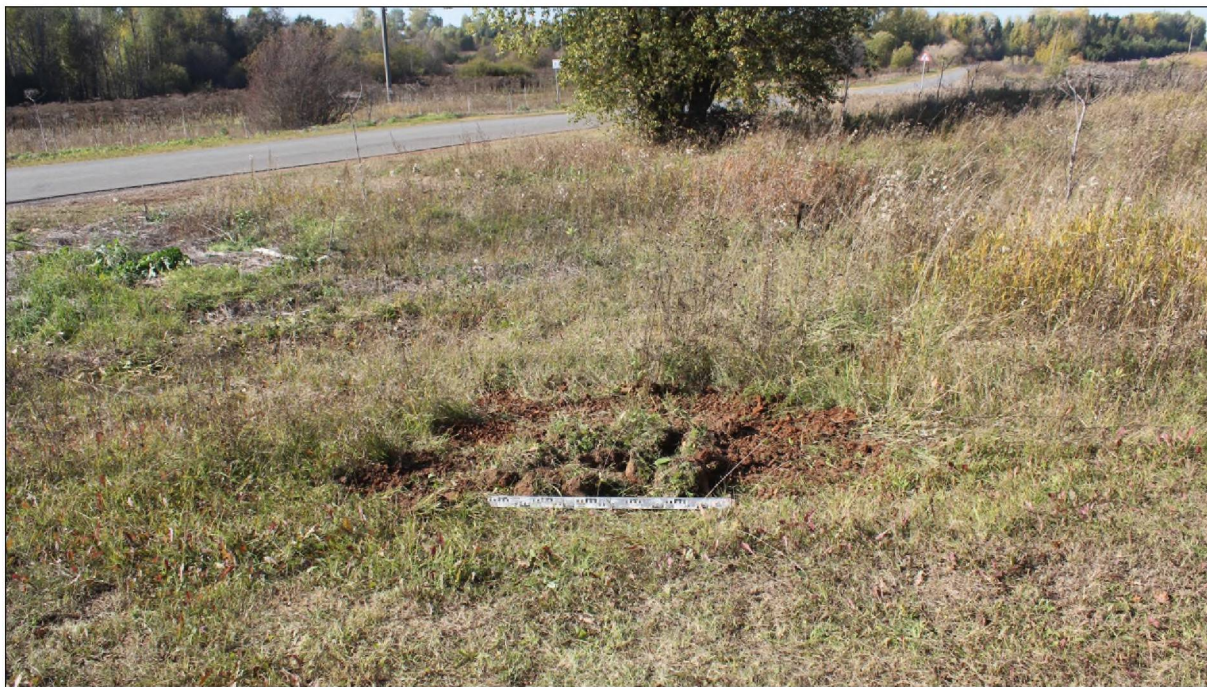
Рис. 37. Кировская область, Кирово-Чепецкий район. «Газопровод распределительный в дер. Ванихинцы Кирово-Чепецкого муниципального района Кировской области». Шурф 3. Рекультивация. Вид с востока.
