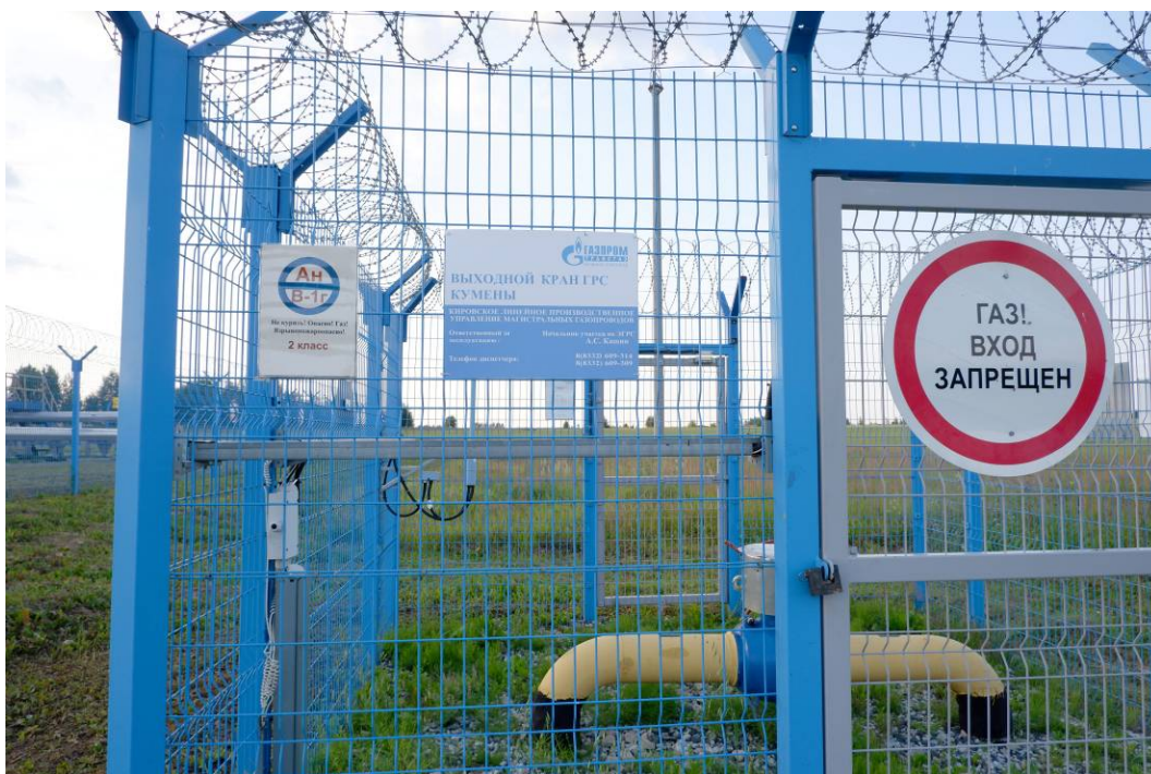
Илл.22. Кировская область, Куменский район. Земельный участок, отводимый под объект: «Оснащение ИТСО ГРС Кировского ЛПУМГ и Моркинского ЛПУМГ». Выходной кран ГРС Кумены.
