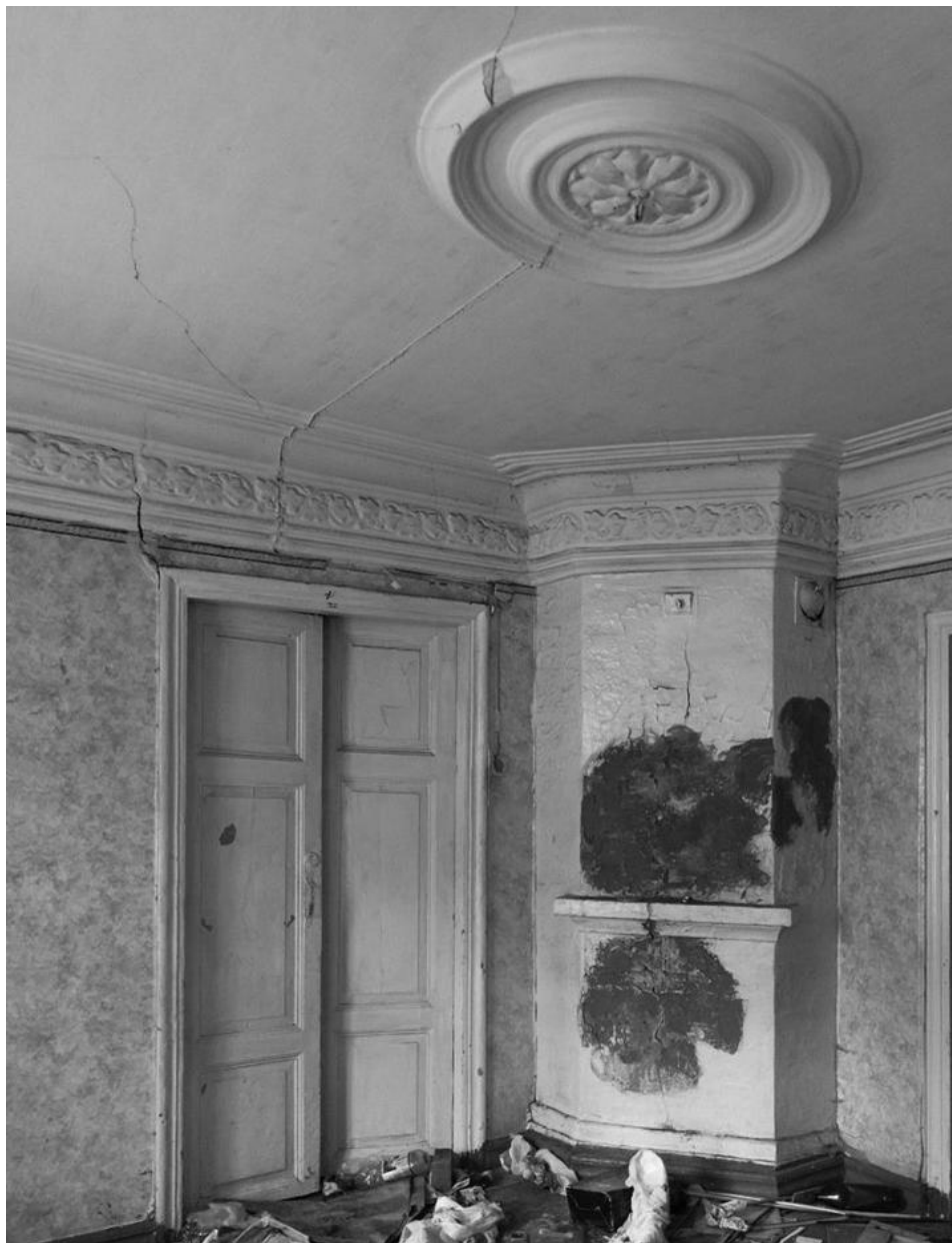
Илл 26. Фрагмент карниза, розетка в помещениях Объекта. Фото 2016 г.
