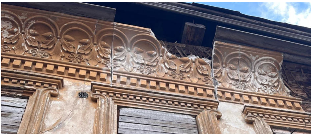
Илл. 33. Северный фасад, следы выпиливания части венчающего карниза. Фото Д.В. Марьин, 2026 г.
