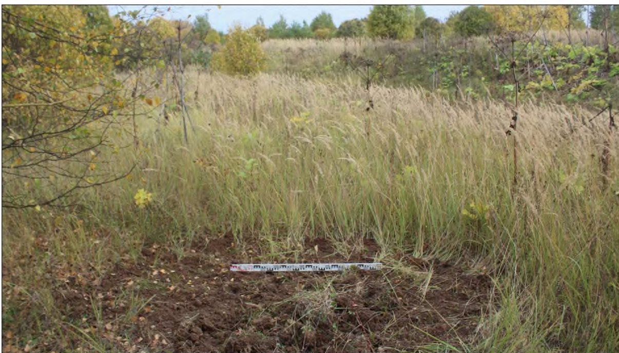
Рис. 49. "Межпоселковый газопровод от ГРС Марийский НПЗ до пгт Килемары Республики Марий Эл". Этап 3 Строительство межпоселкового газопровода от пгт Санчурск Кировской области до границы Республики Марий Эл. Шурф 7. Рекультивация. Вид с востока.
