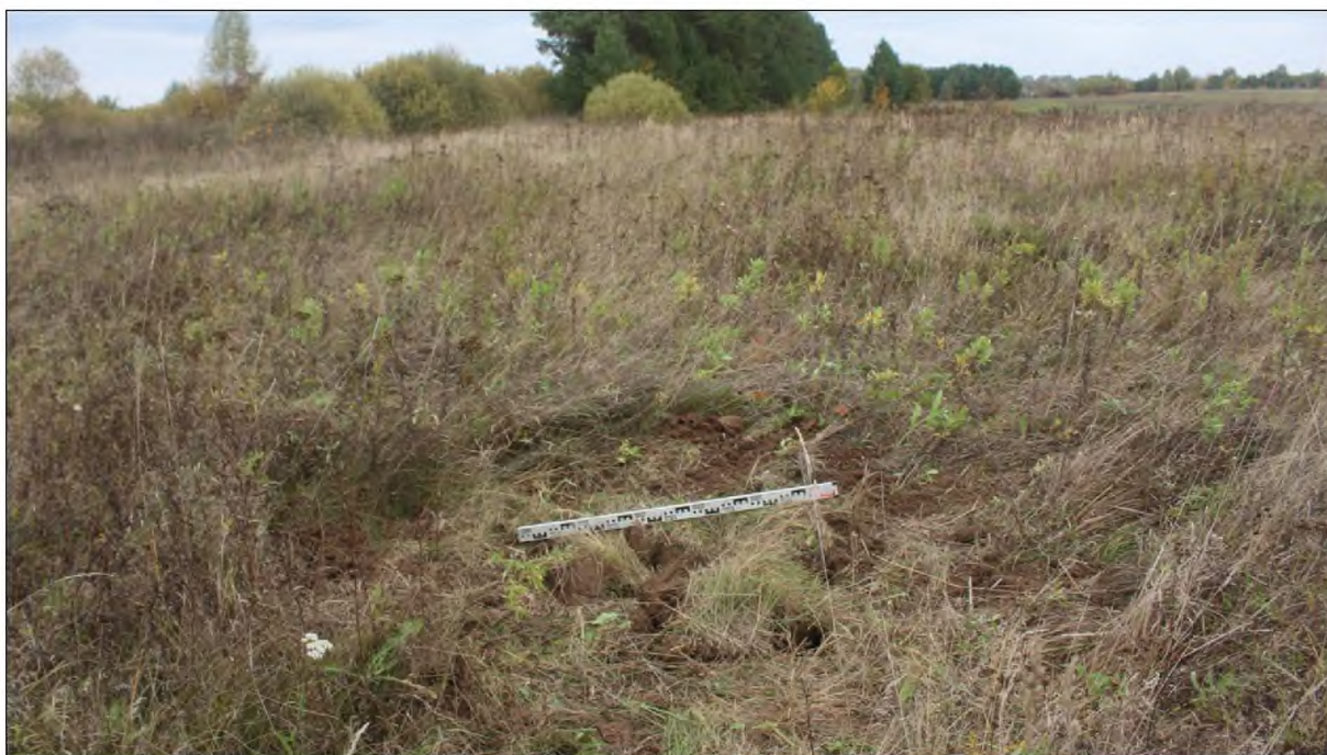
Рис. 25. "Межпоселковый газопровод от ГРС Марийский НПЗ до пгт Килемары Республики Марий Эл". Этап 3 Строительство межпоселкового газопровода от пгт Санчурск Кировской области до границы Республики Марий Эл. Шурф 1. Рекультивация. Вид с юга.
